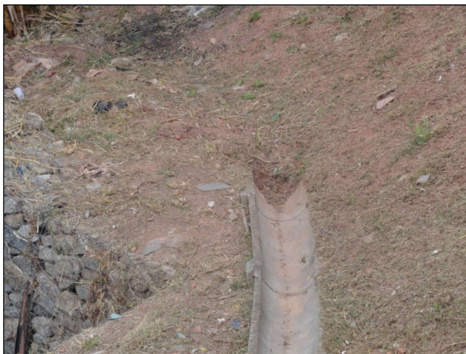
Foto FC-ITA-03-01.04: Detalhe do final da drenagem do aterro sem a devida destinação para a água.
