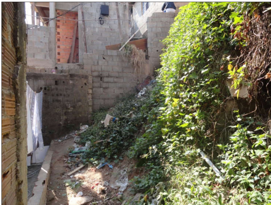
Foto FC-ITA-01-01-03.01: Notar a proximidade da moradia ao talude de corte e a inclinação deste. Embaixo da vegetação encontra-se bloco de rocha de dimensões métricas.
