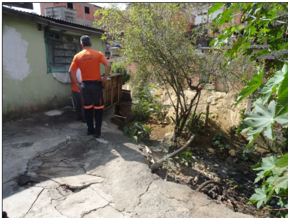
Foto FC-ITA-01-06.03: Vista do quintal de moradia tendo ao fundo a margem do córrego entulhada por solo e entulho.
