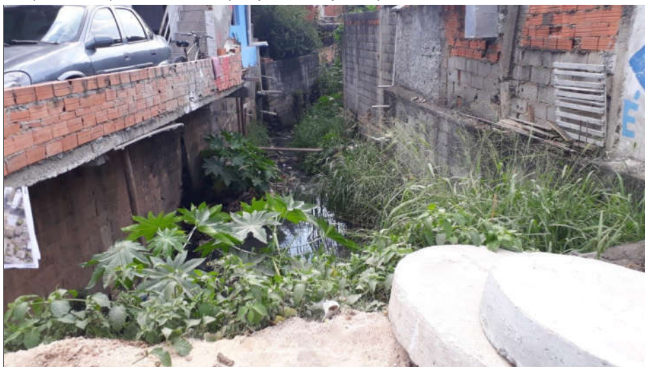
Foto FC-ITA-01-03.02: Detalhe do córrego com margens ocupadas por moradias e grande quantidade de vegetação dentro do canal. Observar a grande quantidade de tubos que lançam águas pluviais e esgoto no córrego.
