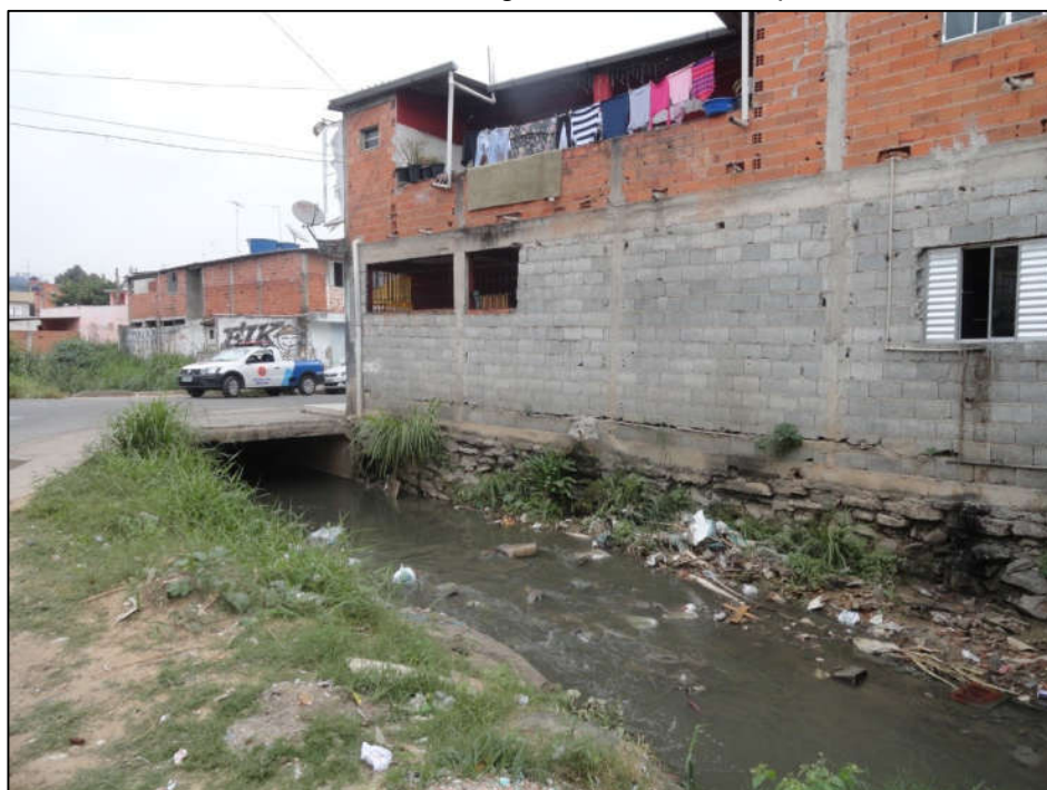
Foto FC-ITA-03-02.02: Detalhe do córrego com margens ocupadas por moradias logo após a travessia da rua. Observar as moradias sobre o talude marginal.
