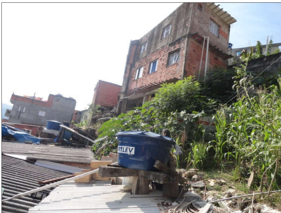
Foto FC-ITA-01-01-01.04: Moradias encostadas nos taludes de corte. Notar a alta densidade da ocupação.
