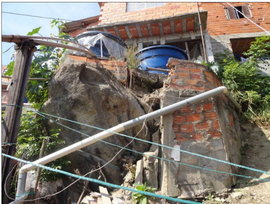
Foto FC-ITA-01-01-02.01: As duas caixas d'água instaladas sobre laje já rompida sobre bloco de rocha.
