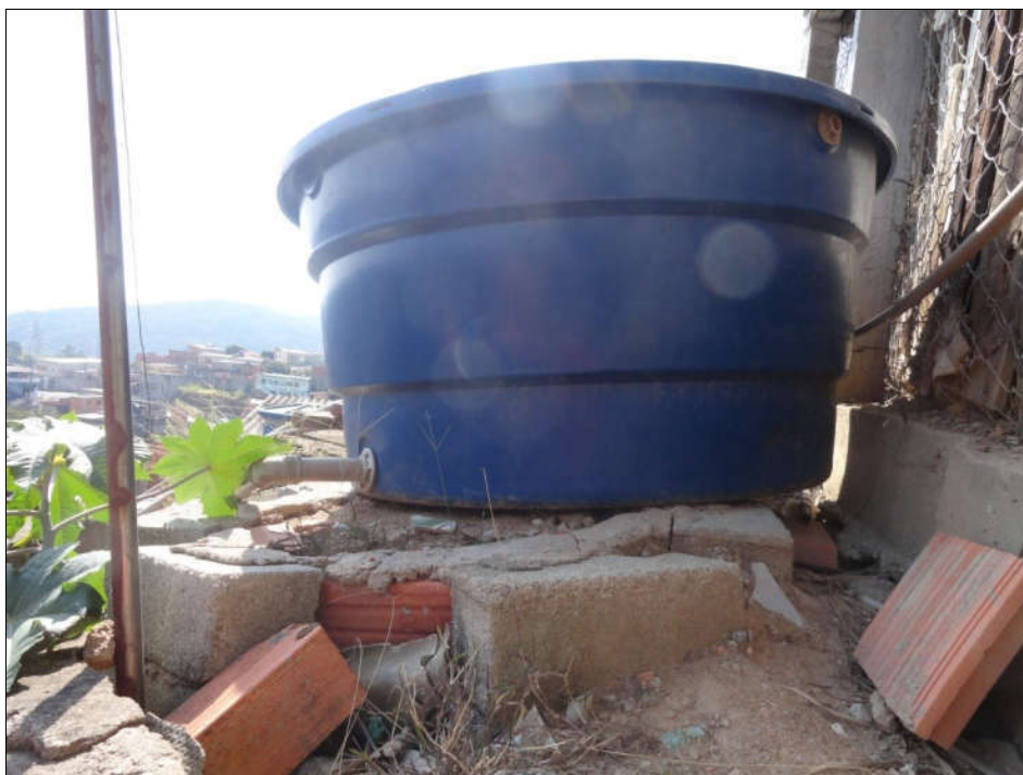
Foto FC-ITA-01-01-02.02: Caixa d'água sobre laje com problemas construtivos.
