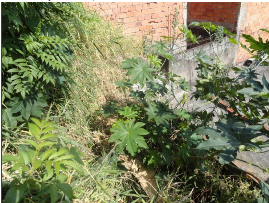
Foto FC-ITA-01-01-02.04: Situação do talude de corte nos fundos da moradia.
